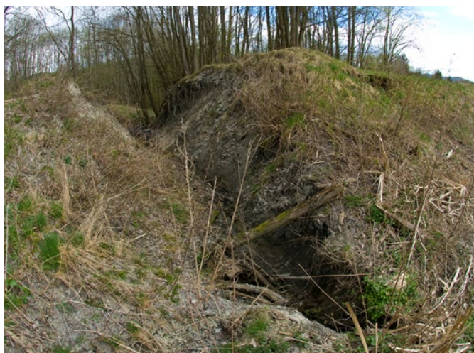
Bilde 8.8. Bilde av en demning som er laget av leire i en ravine. Her har bekken vasket ut langs røret som var lagt som utløp i dammen og vannstanden i dammen har gått kraftig ned.
