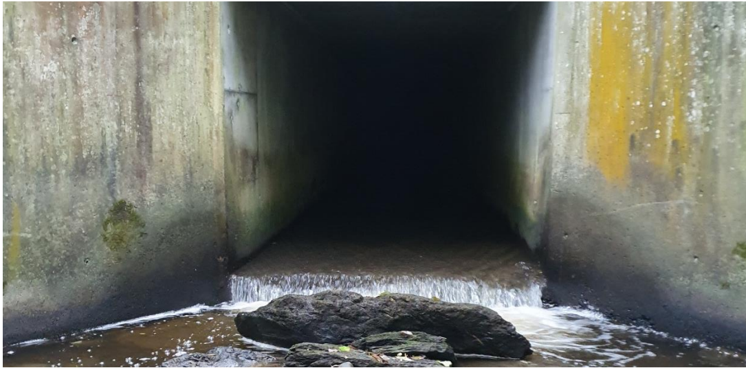
Figur 20: Kulvert under Skansenvegen glatt betongbunn, stor fallgradient og høy vannhastighet
