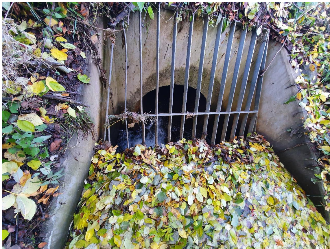
Figur 49: Start kulvert som går under Liavegen. Ca. 0,5 meter sprang ned til kulvertbunn før kulverten går helt ned til fjorden.
