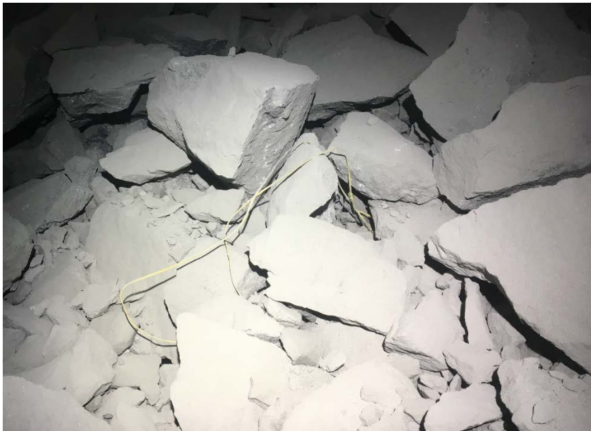
Figur 5: Skyteledning i røysa, testsalve 2
