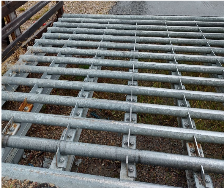
Bilde 12: Eksempel på ferist ved Femundsenden som stopper rein fra å krysse veien. Her er det 15 cm mellomrom mellom rillene (dobbelt så langt som normalt) og 45 cm dybde under rista. Utfordring: Statens vegvesen har ikke godkjent denne typen ferister ennå (foto: I. Hansen).
