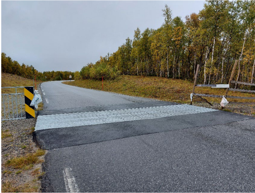
Bilde 10: Ferist på Myrmoen som er lagt for å skjerme innmarksarealer (på den siden som fotoet er tatt) fra rein, men som ikke fungerer etter hensikten. Utfordring: Avstanden mellom rillene i ferista er for kort. Avstanden mellom rillene på dette bildet er rundt 7,5 cm (standard) (foto: I. Hansen).
