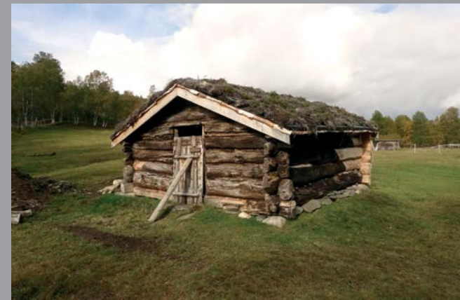
Fjøset på Bruavollen i Synnerdalen er restaurert og har fått nye vindskier i tråd med de gamle.
