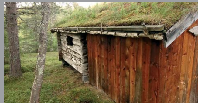
På Museumssetra i Synnerdalen er taket både på et fjøs og ei seterstue tekket om med bruk av einerkroker, torvhall og never som dekker takkanten. Grunnmursplaten er skjult så godt det lar seg gjøre. Takutstikket er bare 15-20 cm. Vindskiene er smale og uten dekor.
