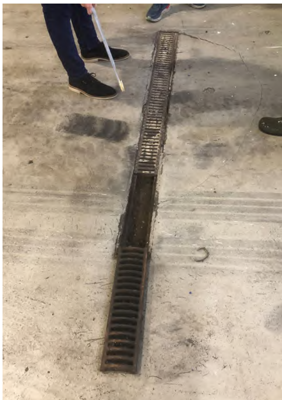
Figur 15 Aco-drain avløpsrenne i forkant av leddport i verkstedhallen (foto: COWI AS).
