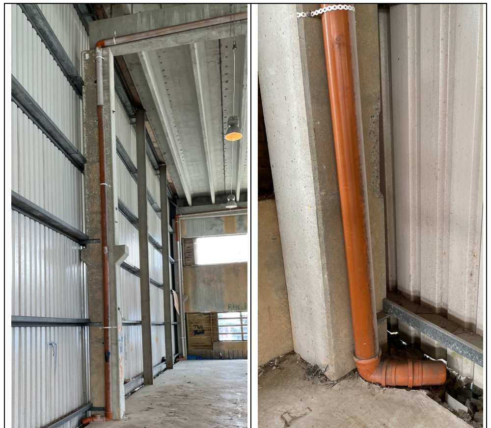
Figur 10 Foto som viser innvendig takrenne i bygg 3 (foto: COWI).
