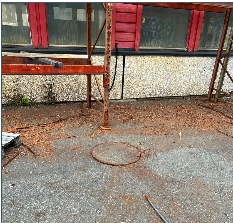
Figur 11 Foto fra sørsiden av bygg 1 som viser avløpskum (foto oversendt av Atracco).
