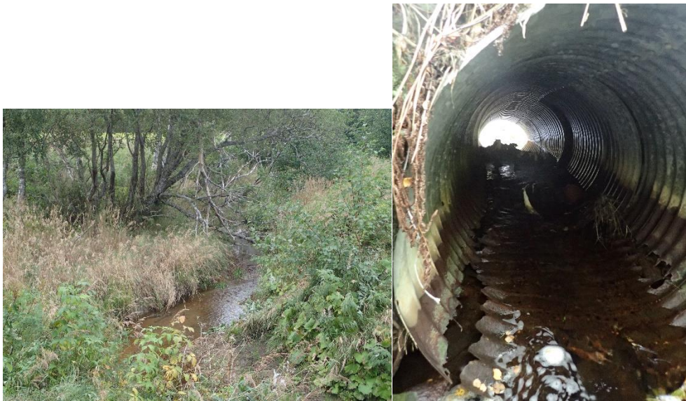
Bilde: Svartbekken og tilstoppet kulvert i bekken.
