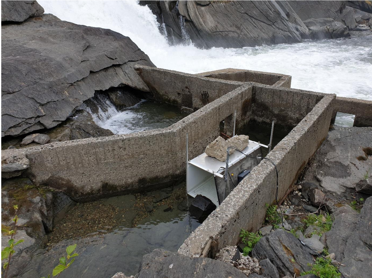
Bilde: Plassering av videotunellen i fisketrappa i Drevja. I forkant av videotunellen er det montert et ledegerje slik at fisken ikke kan passere utenom. Fisketrappa i Drevja. Foto: Aslak Darre Sjørusen
