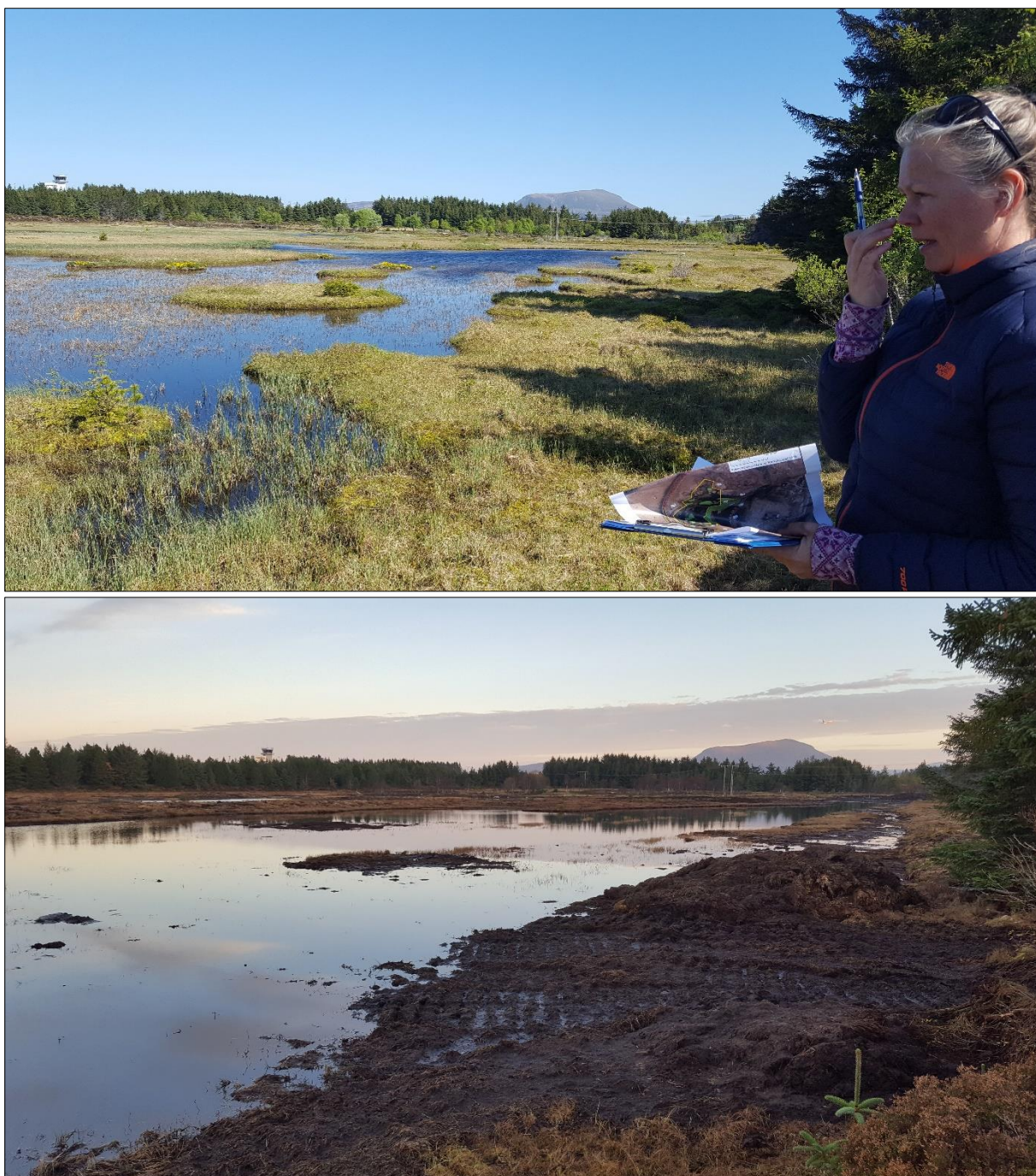
Figur 8. Østre del av Rørvikvatnet før og etter restaurering. Øverst: Fra tilbudsbefaring med Solveig Silset Berg (FMMR) til høyre i bildet. Nederst: Fra siste befaring den 8. november. Vannspeilet har økt betraktelig etter restaureringsarbeidet. Foto: Linn Eilertsen.
