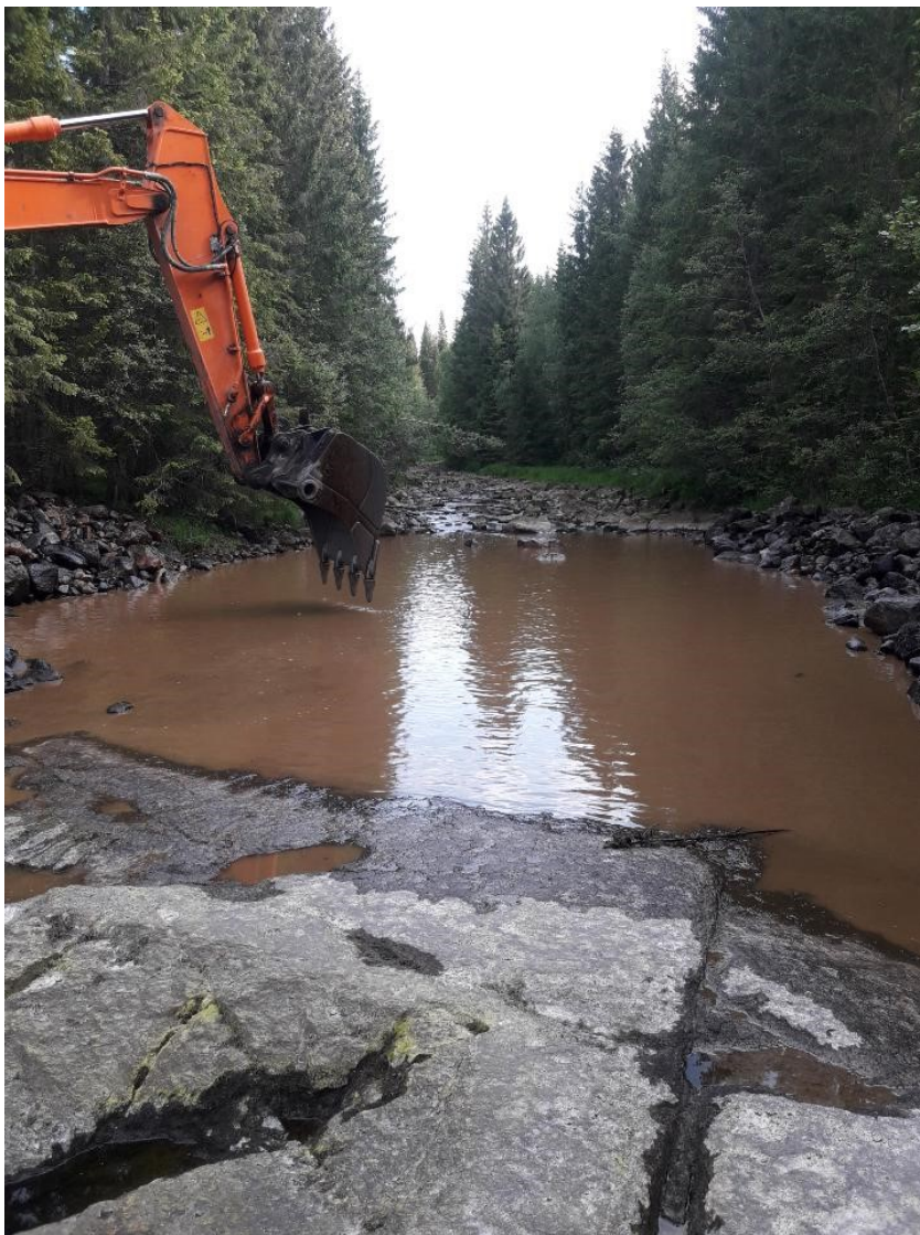
Figur 10: Gravemaskinen graver større og dypere kulp i et av biotoptiltakene i Mykleelva.
