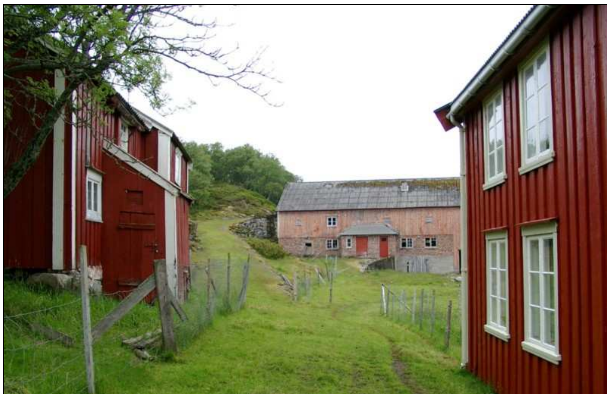
Figur 12. Bygningsmiljøet på Lya fremstår som nokså komplett og velholdt. Våningshusa i Lyabukta er i god stand, men det store fjøset fra 1948 må ha nødvendig opprustning.
