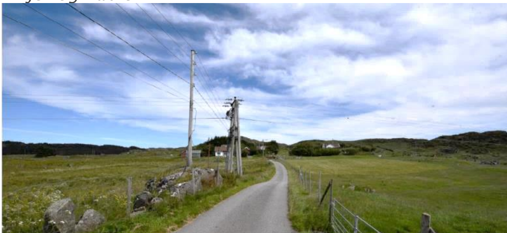
Figur 6-4-7: Stolpetrafo på 22 kV linje og lavspentlinjer Medhaugvegen. Kilde: COWI
