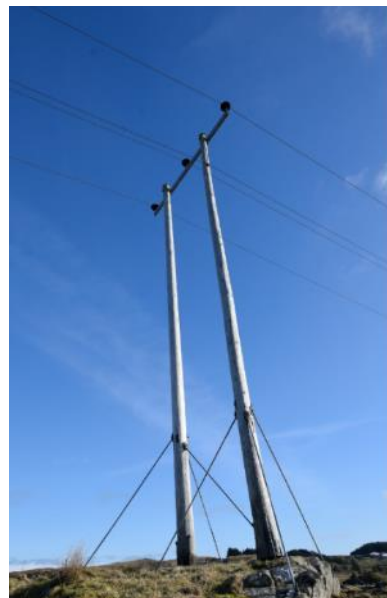
Figur 6-7-4 Mast for 22 kV høyspentlinje sør for Tostemmen. Kilde: COWI
