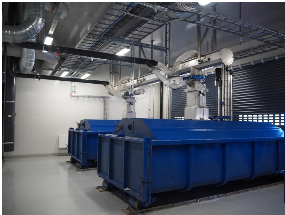
Bilde 1: Containerstasjon med lukkede slamcontainere
