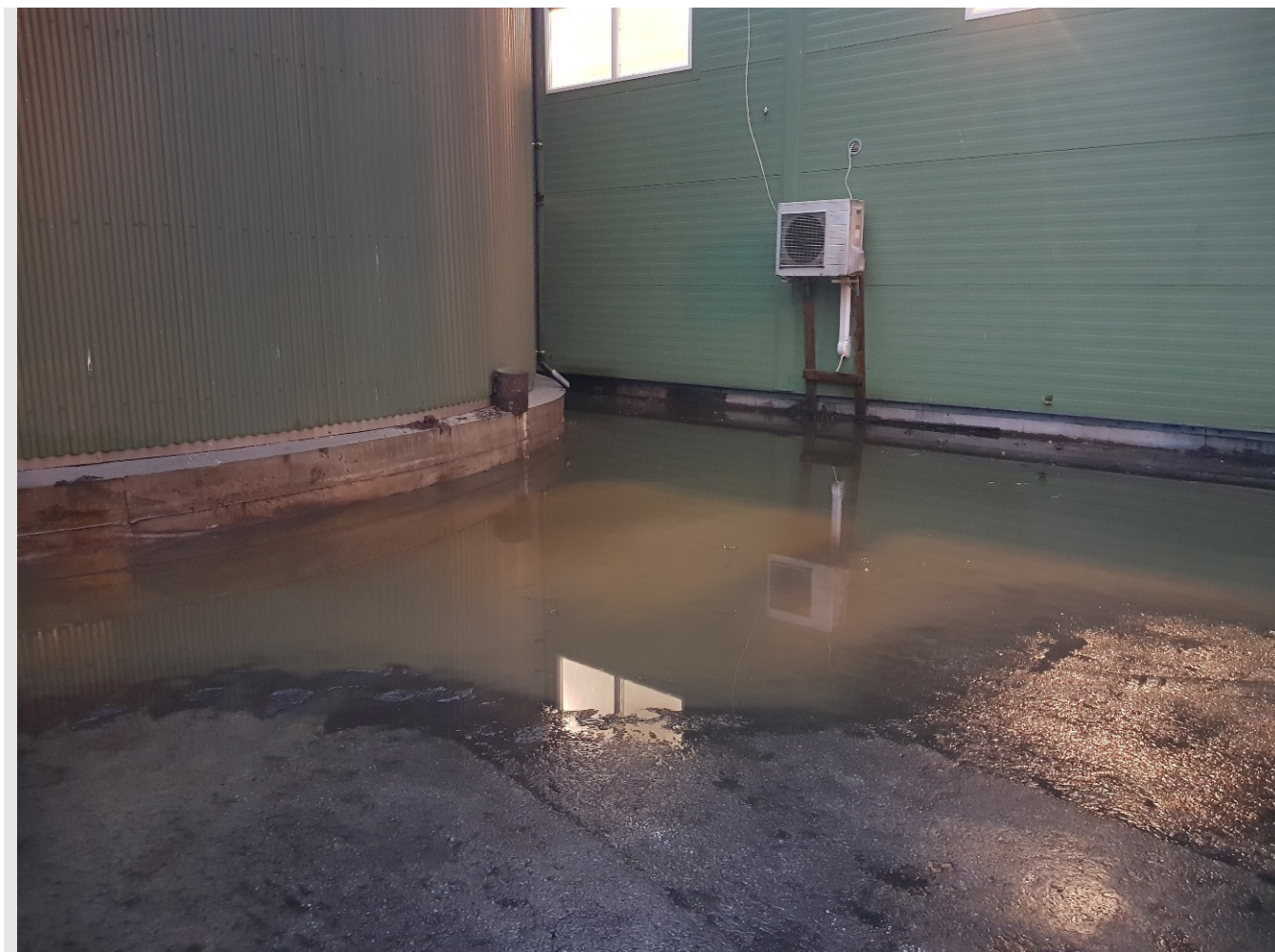
Vannansamling bakside tank.
