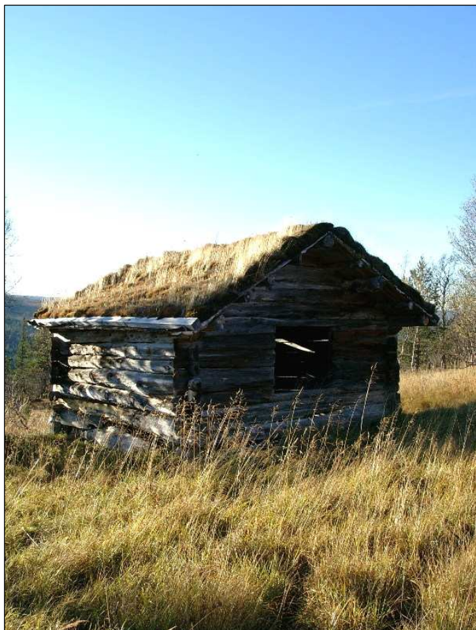
Figur 7. I Storbekklia ved Tovmoen finnes svært mange gamle høylører som er satt i stand. Disse kulturminnene representerer en viktig del av gårdshistoria og er i seg selv flotte elementer i landskapet.
