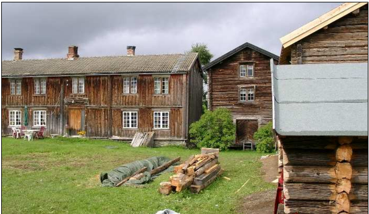
Figur 23. Tunet på Sør-Solberg Oppstu er et godt bevart kulturmiljø med 1800-tallsbygninger hovedsakelig i upanelt tømmer. Det er lagt ned et stort restaureringsarbeide her, men mye arbeid gjenstår ennå før hele tunet er satt i stand.
