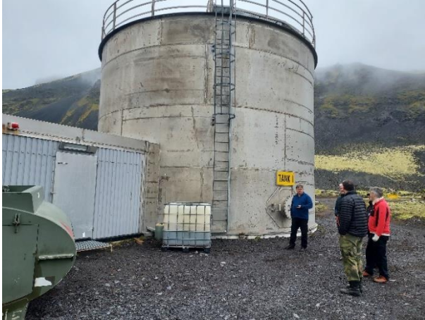
Usikret kontainer ved tank 1 for oppsamling av dieselrester etter prøvetaking
