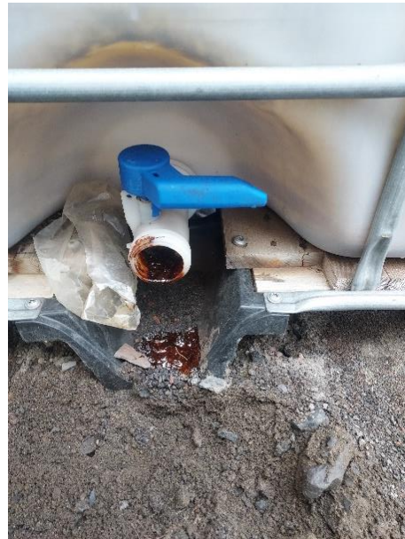
Tydelige spor og lukt fra lekkasje
