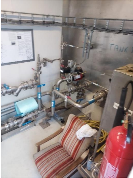
Inne fra pumpehuset mellom tank 1 og 2
