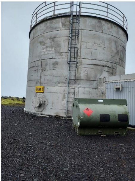
Tank 2 og deler av pumpehuset
