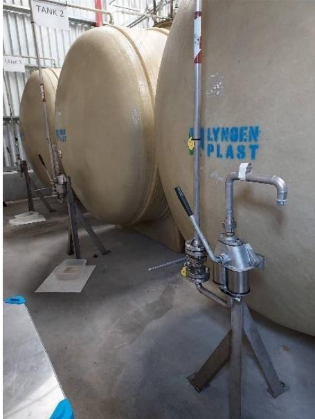
Tre tanker som er plassert i lukket anlegg ved flyplassen
