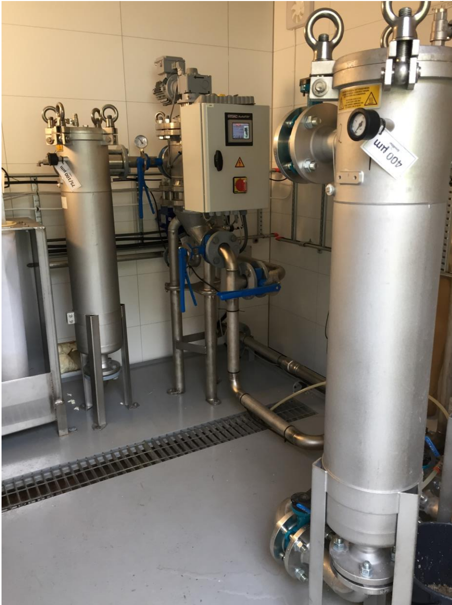
Figur 3.1. Filtreanlegg for fjerning av mikroplast
