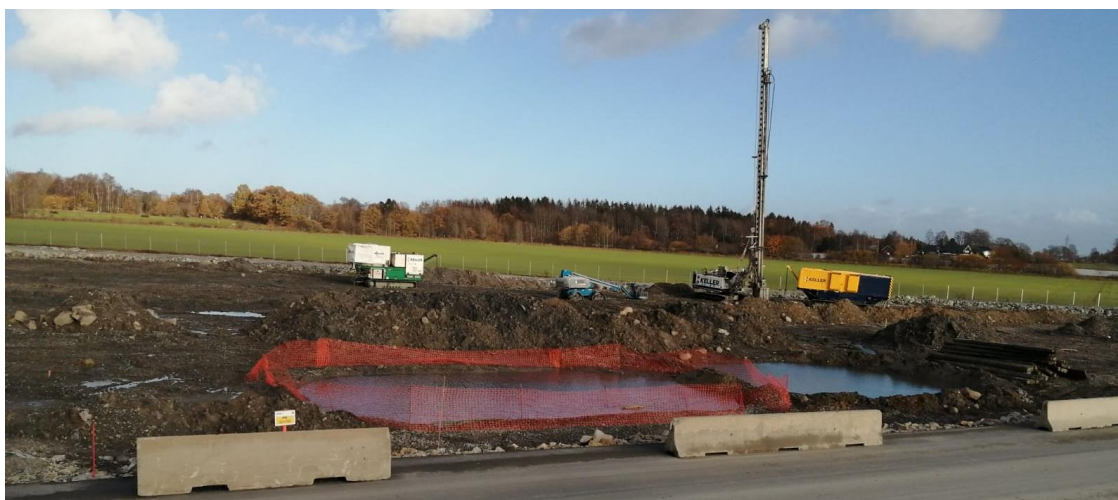
Figur 4. Dammer for oppsamling av anleggsvann på Carlberg.
