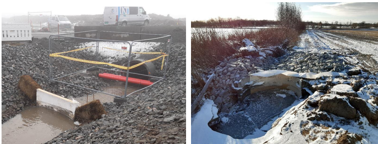
Figur 3. Filterduk og påfølgende høyballer i avskjærende grøft som leder vann til Gunnarsbybekken er vist i venstre bilde. Til høyre vises en av to midlertidige terskler (sedimentasjonsbasseng) som er satt nedstrøms utslippspunktet for rensset vann til Gunnarsbybekken for å tilbakeholde partikler.
