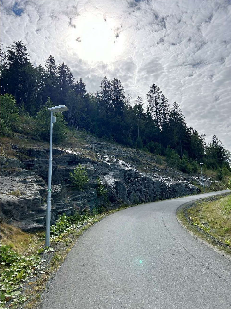
Bilde 1.E: Berg i dagen påvist. Gjelder langs vegen Lersbakken og opp mot tiltaksområdet.
