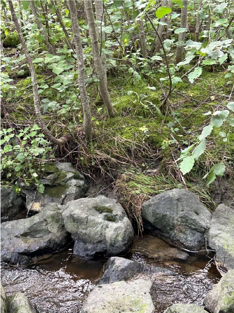
Bilde 2.C: Litt erosjon. Det er leire i bekkeleiet og mindre fraksjoner av erosjonssikringen er ikke tilstede. Omfanget er ikke stort og preger kun enkelte flekker av sideterreng i Sørabekken.
