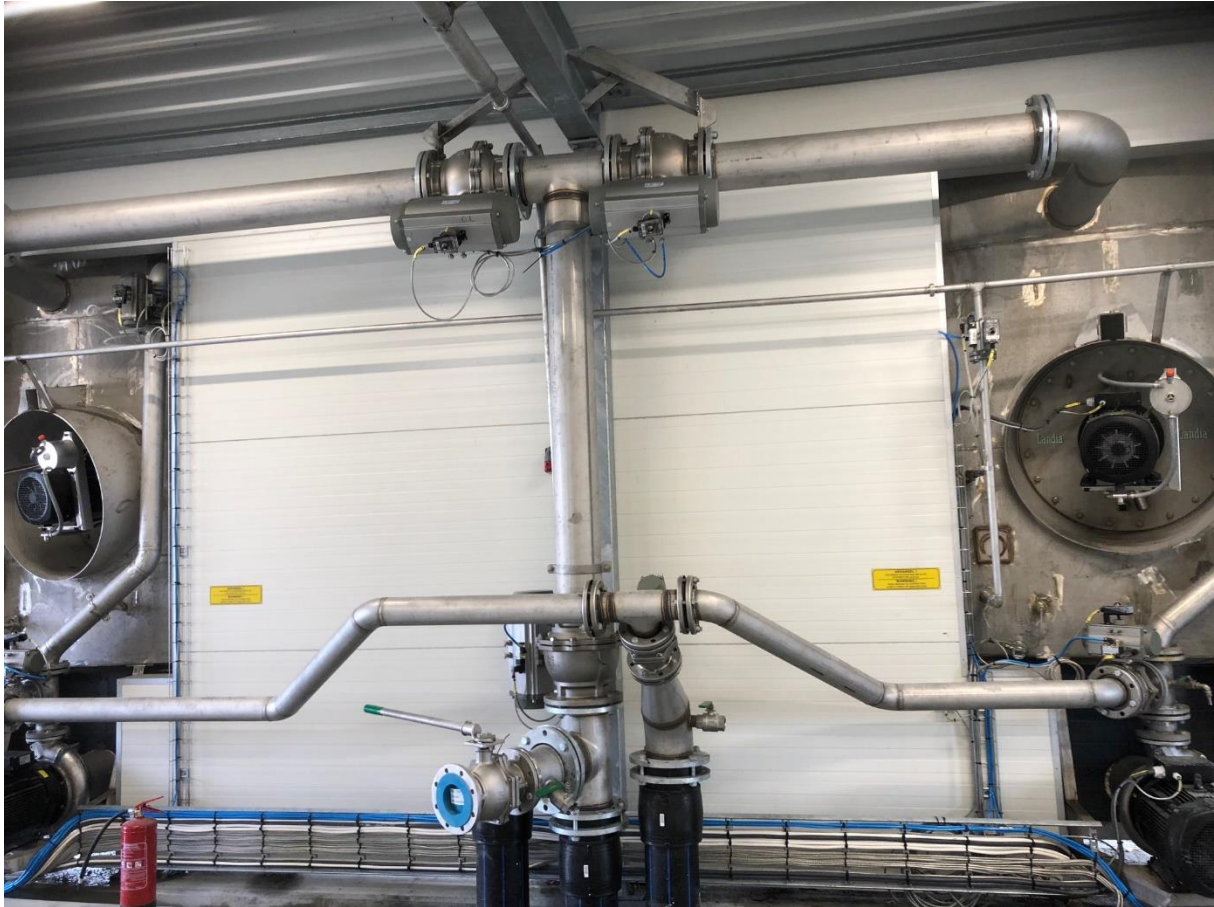
Pumper og rørføringer mellom tankene er montert inne i pumpehuset.
