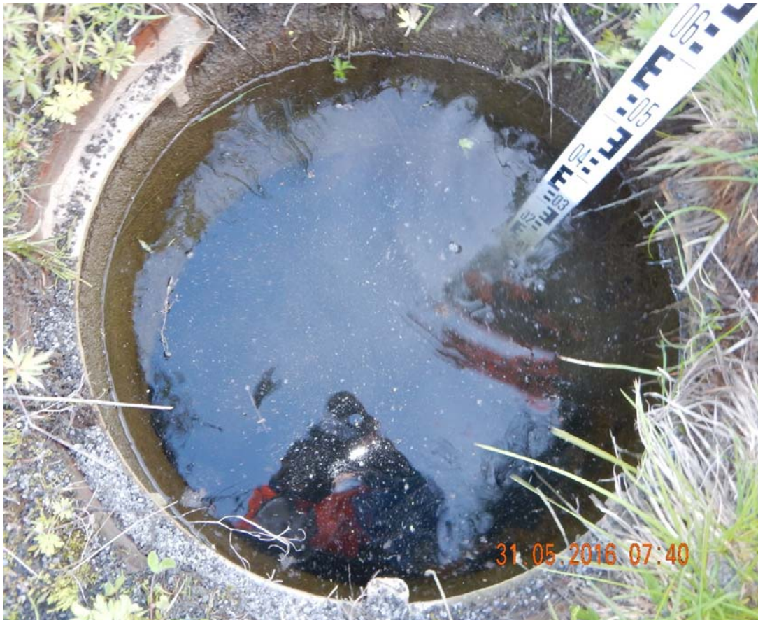
Bilde 1 – Overvannskum er fullt av vann fordi utløpsrør er tett.
