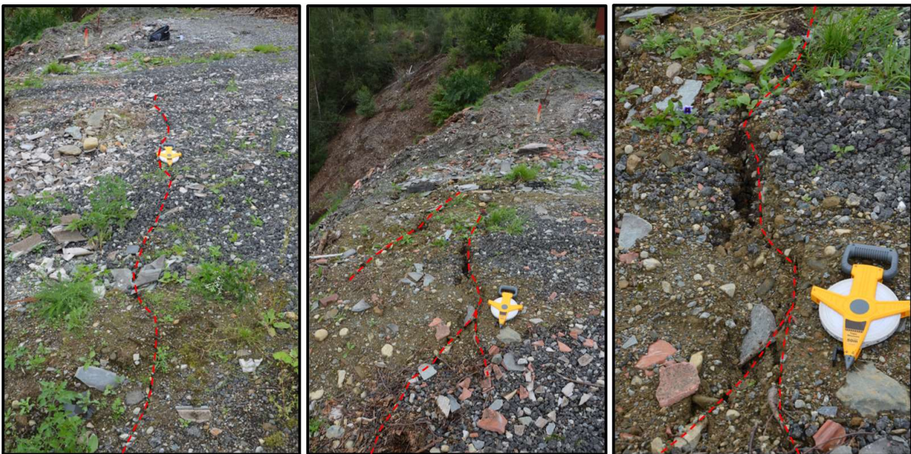
Figur 17 Bildene viser observerte setninger i deponiets øvre kant (markert med røde stiplede linjer) angitt som lokasjon 9 i Figur 12. Bildet til venstre viser hele deponikanten hvor setningene vises med betydelig utbredelse (+/- 10 meter). Bildene mot høyre viser setningene i mer detalj.
