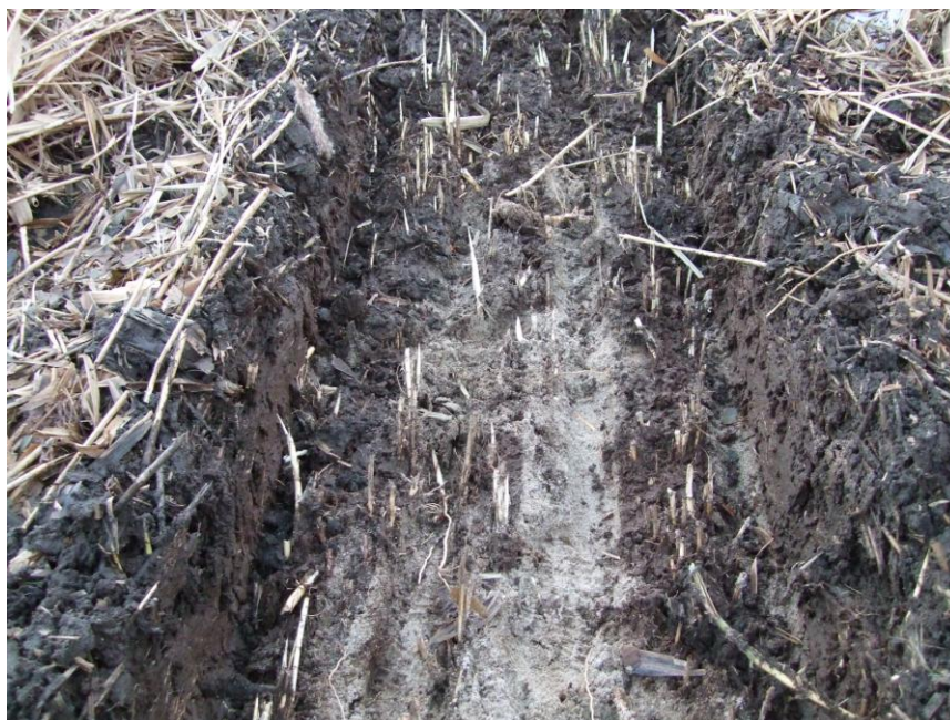
(RK)´s opgravning til filterlag i bassin nr. 1 ca. 2-3 meter fra væg ind mod bassin 3.
