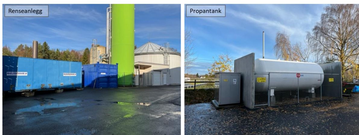
Figur 10: Bildet til venstre: Renseanlegget med utjevningsbasseng og tanken for selve HyVAB-prosessen pågår. Bildet til høyre: LPG-propantank med påkjøringsvern på kortsidene og gjerdet på langsiden. Fordamperskap er låst, og plassert til venstre for selve tanken
