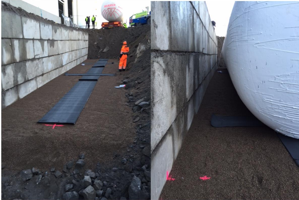
Figur 13. Bilder fra når gasstank ble plassert i nedgravet grop, desember 2015 (tilsendt av Sørlandschips AS)
