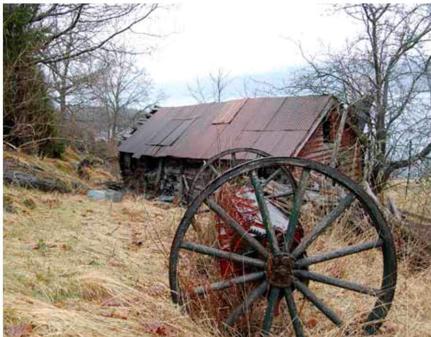
I store deler av landet er seterdrifta lagt ned, og bygningene som står igjen i landskapet trenger sårt pleie og stell.
