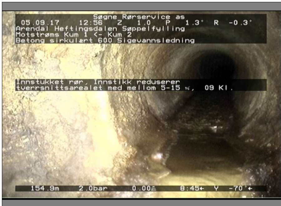
Foto: 2_1_9_05092017_125530_A.JPG 154,97m, Innstukket rør, Innstikk reduserer tverrsnittsarealet med mellom 5-15 %, 09 Kl.
