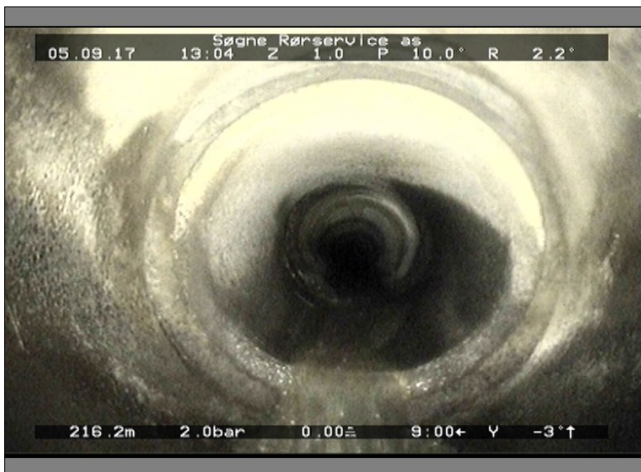
Foto: 2_1_14_05092017_130338_A.JPG 217,35m, Dimensjonsendring til 400, ?
