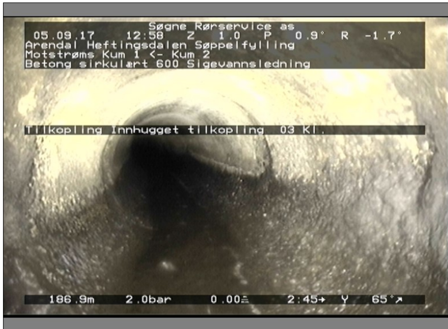
Foto: 2_1_11_05092017_125752_B.JPG 186,9m, Tilkopling Innhugget tilkopling 03 Kl.
