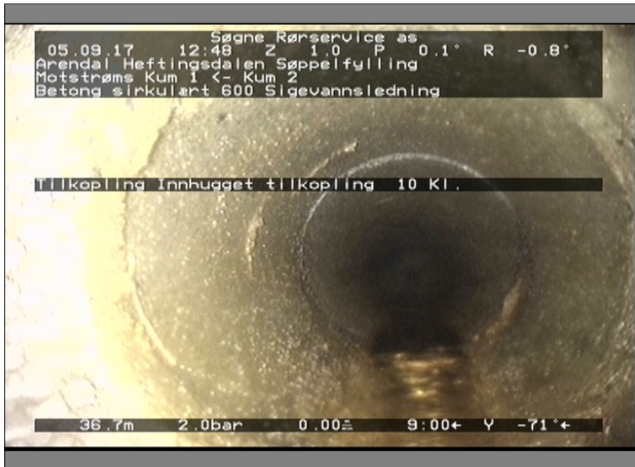
Foto: 2_1_5_05092017_124756_A.JPG 36,77m, Tilkopling Innhugget tilkopling 10 Kl.
