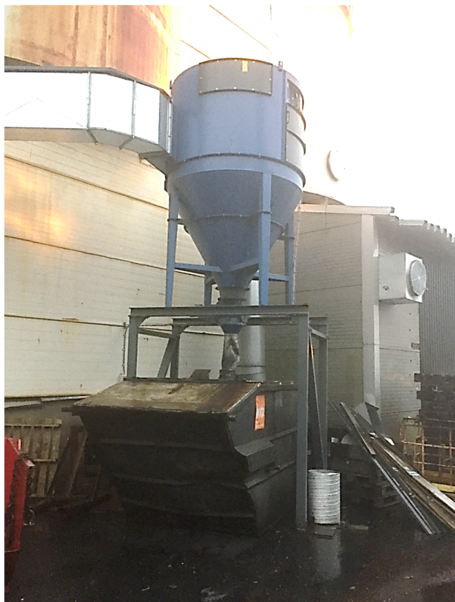
Figur 6: Viser nytt filteranlegg for oppsamling av støv ifra sikteanlegget.
