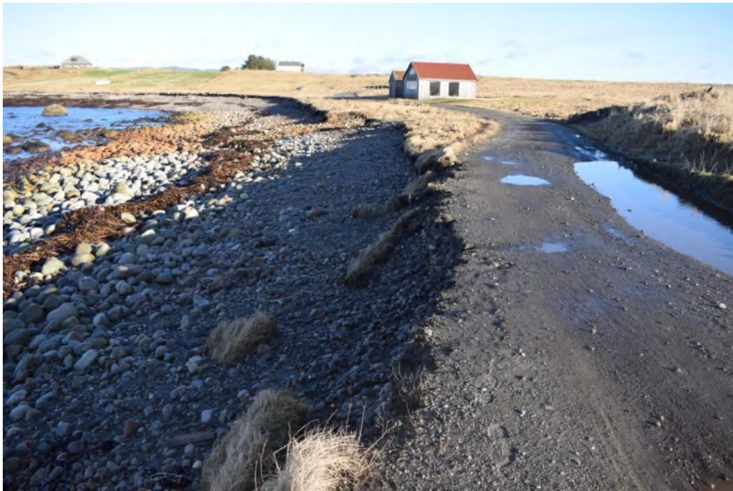
Fig 9. Steinsvika. Erosjonsskader langs veg. Restaurert sjøbu i bakgrunnen
