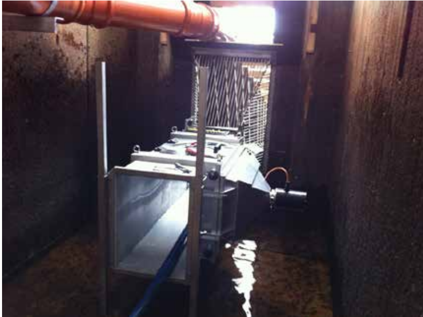
Figur 7. Fiskräknare (Riverwatcher, Vaki) med videoenhet installerad i anslutning till denilrännans översta del. Foto: Pär Gustafsson
