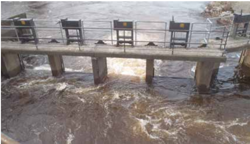
Figur 5. De fem ingångarna med reparerade justeringsanordningar för höjdjustering av luckorna för styrning av vattenutflödet samt vattenarean i fiskvägsmyningen. Foto: Stefan Stridsman.
