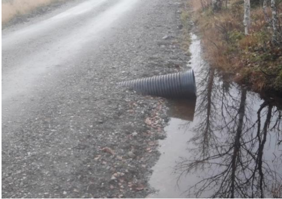
Når stikkrenna er lagt for grunt, oppstår det fort behov for vegvedlikehold. Foto: C. O. Holen
