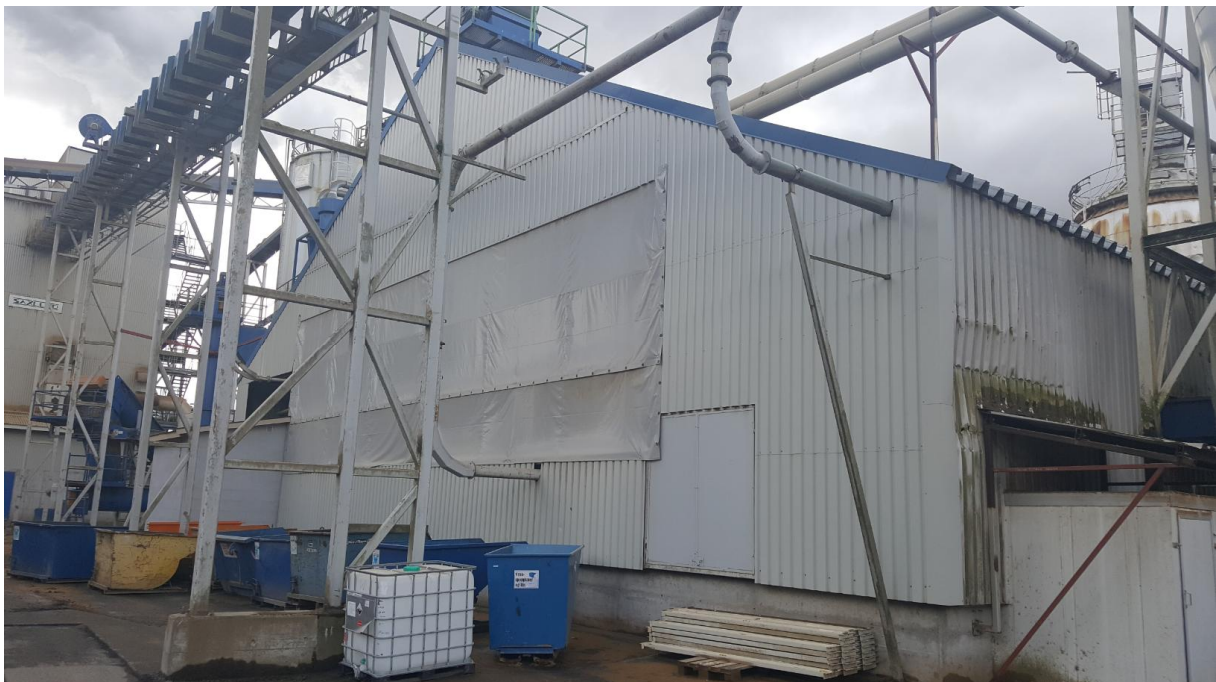
Figur 2: Tetting av sikthus. Tettingen er med plastduker og vil ha noe begrenset lydreduserende effekt.
