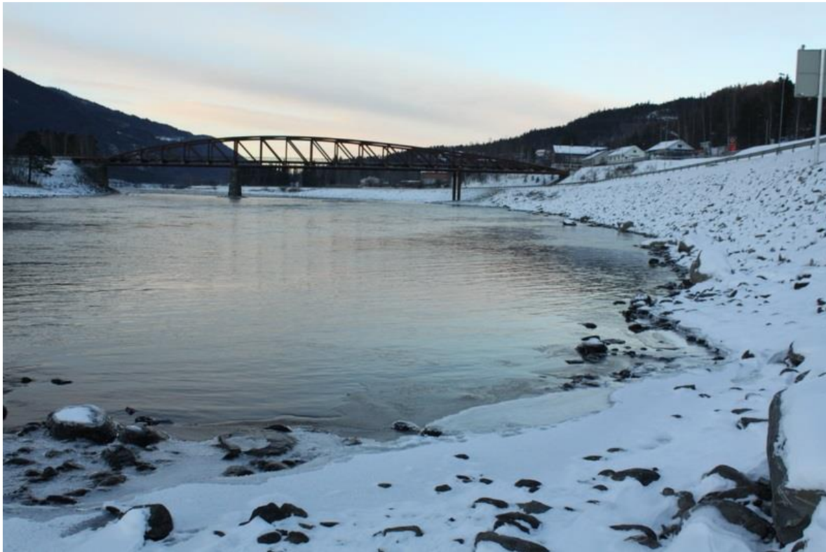
Trettenstrykene sør for brua. 07.12.2013. Elvekanten består av bratt fylling mot E-6. Stein bør plasseres ved foten av denne og et stykke utover i elva. Foto: Jon Opheim.
