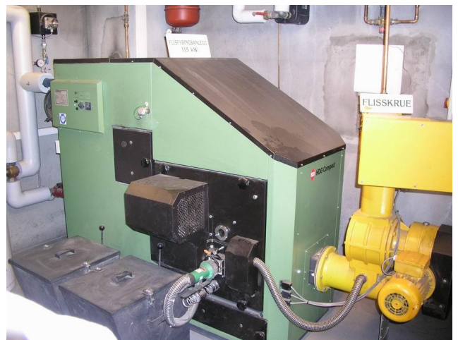
Flisfyringskjel (115 kW) fra 2007 Egen flissilo t.h. utenfor bildet
