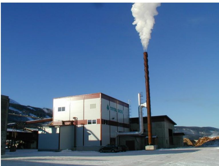
Varmesentralen ved Trysil fjernvarme (7,5 MW bio) 1980/2003
