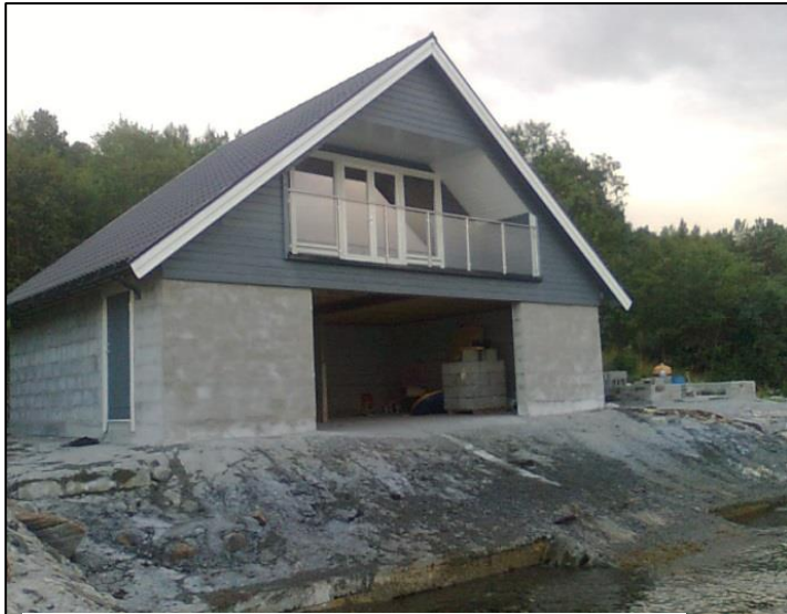
Bygging i strandsonen et konfliktområde. Fra Nerås.
