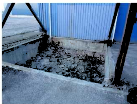
Figur 10. Etter fjerning av forurensete masser ved dieselpåfyllingen.
