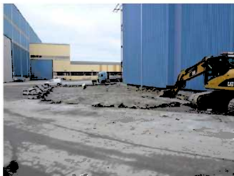
Figur 6. Etter fjerning av forurensete masser ved store sandblåserhallen.
