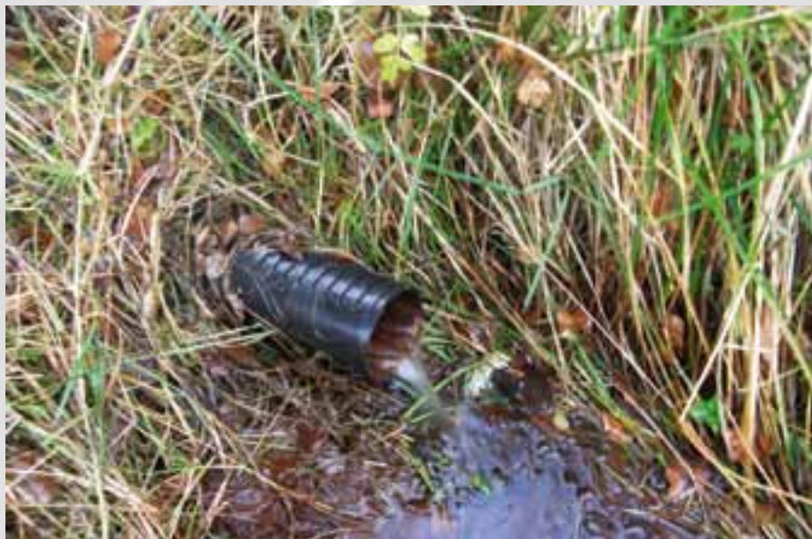
Grøfterøyr med noko rustutfelling. Grøftespyling vil unngå tiltetting. Foto: Lars Sørdal
