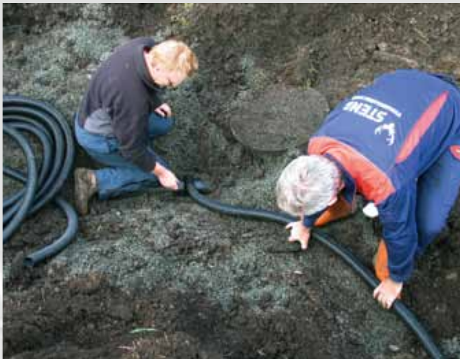
Ennå uferdig sammenkopling av sugerør og samlerør. Det er praktisk å bruke koblingsdel som er tilpasset, og det må brukes godt med filtermateriale på koblingspunktet. Foto: Bente Opstad.
