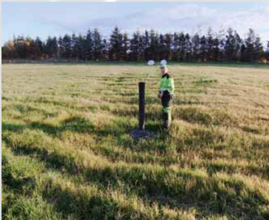
- Rask fjerning av overflatevatn er viktig. Overflateforming og sluk er effektivt. Peder har gode røymsler med dreneringsrøyr i singelsluk. Desse kan reinskast med spyling eller bruk av vakumvog. Røyrret på biletet er 8 tommar i diameter. Det blir kutta ned til overflata, og dekt med sterk rist. Foto: Olav Martin Synnes.
