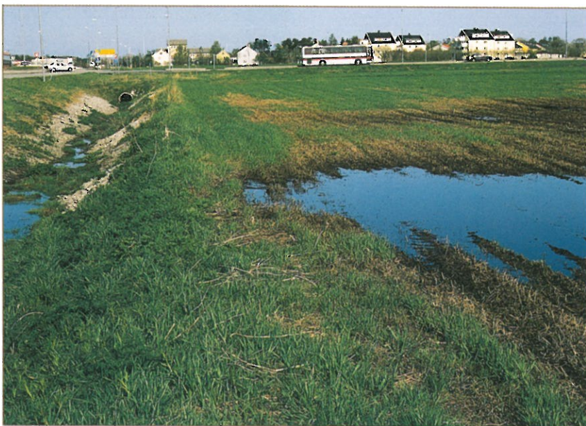
Unngå at det dannes terskler av grøftekantene ved pløying og jordarbeiding. Noen få tak med spaden ville her hatt stor effekt mot is- og vasskader. Foto 04.06.96, B. Volden
