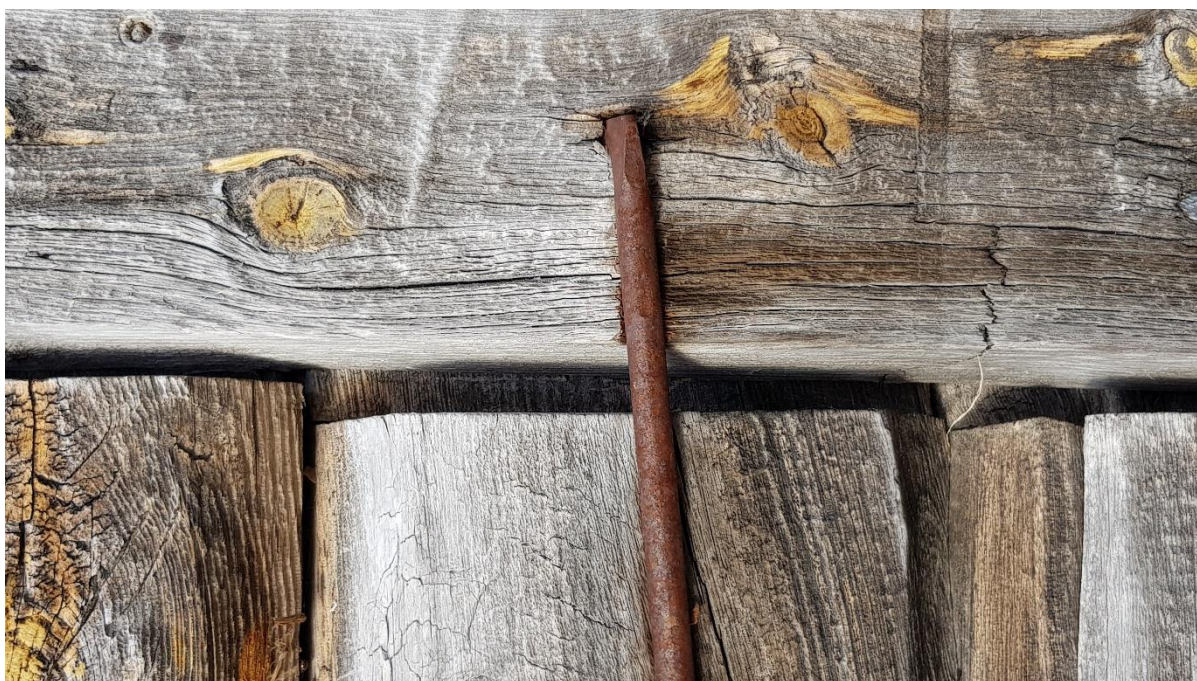
Figur 2.1 «Binding» som holder stokker på plass på et eldre tømmerhus i Salten.
