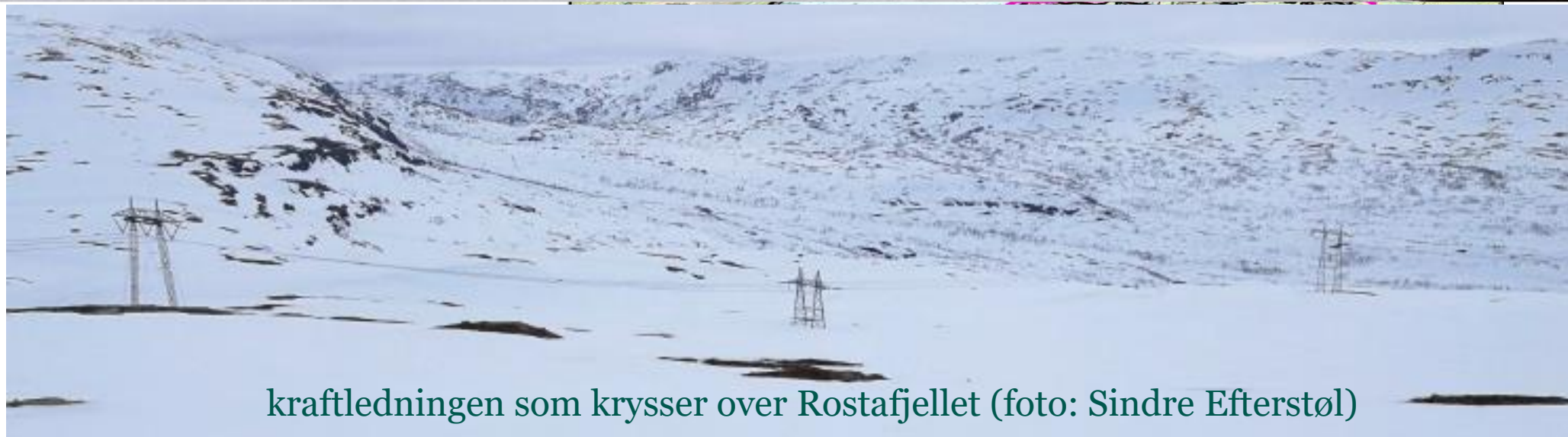
kraftledningen som krysser over Mofjellet (foto: Sindre Eferstøl)
