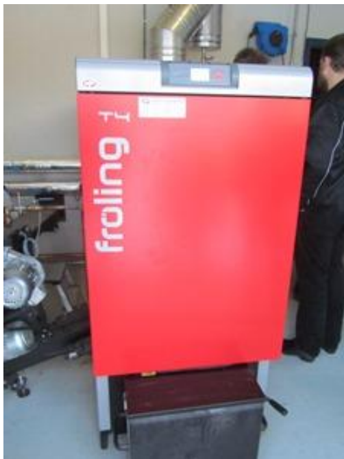
Gårdsvarmeanlegg Mo i Rana 75 kW
