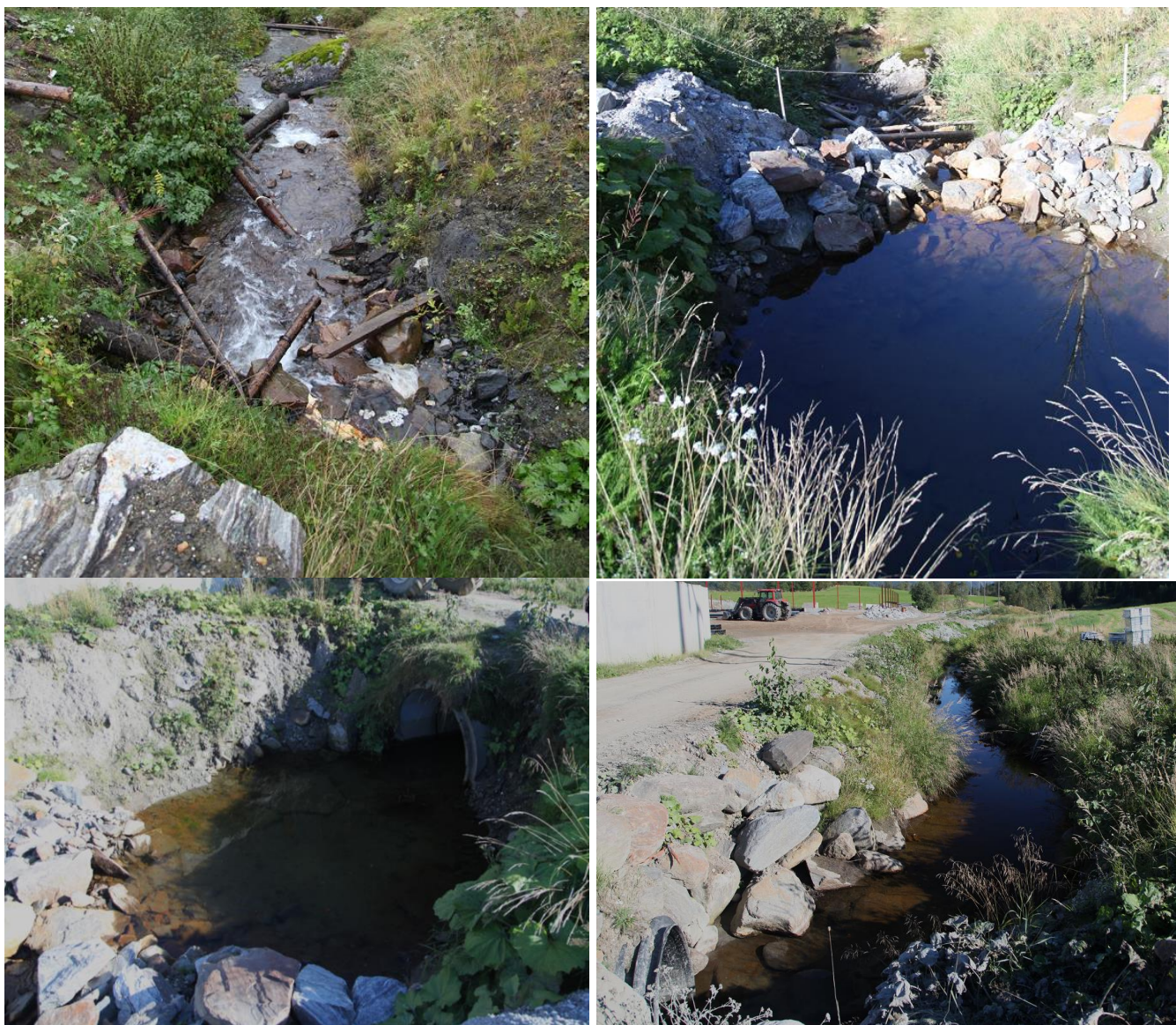
Figur 11 Bilder av kulvert under offentlig vei. Bildet oppe til venstre er tatt nedstrøms kulvert i 2013, mens bildet oppe til høyre viser samme område i 2014. Bildene i nedre rekke viser kulvertens utløp (til venstre) og innløp (til høyre).
