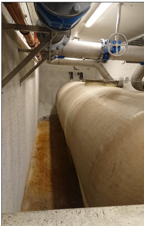
Figur 19. Tank for fellingskjemikalium og oppsamlingskar.
