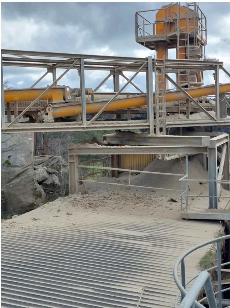
Figur 9: Synlig støvansamling på taket av den eldre delen av anlegget. Haugen ligger i le for vinden, det er noe av grunnen til at støvet ikke har blåst bort, men har bygget seg opp.
