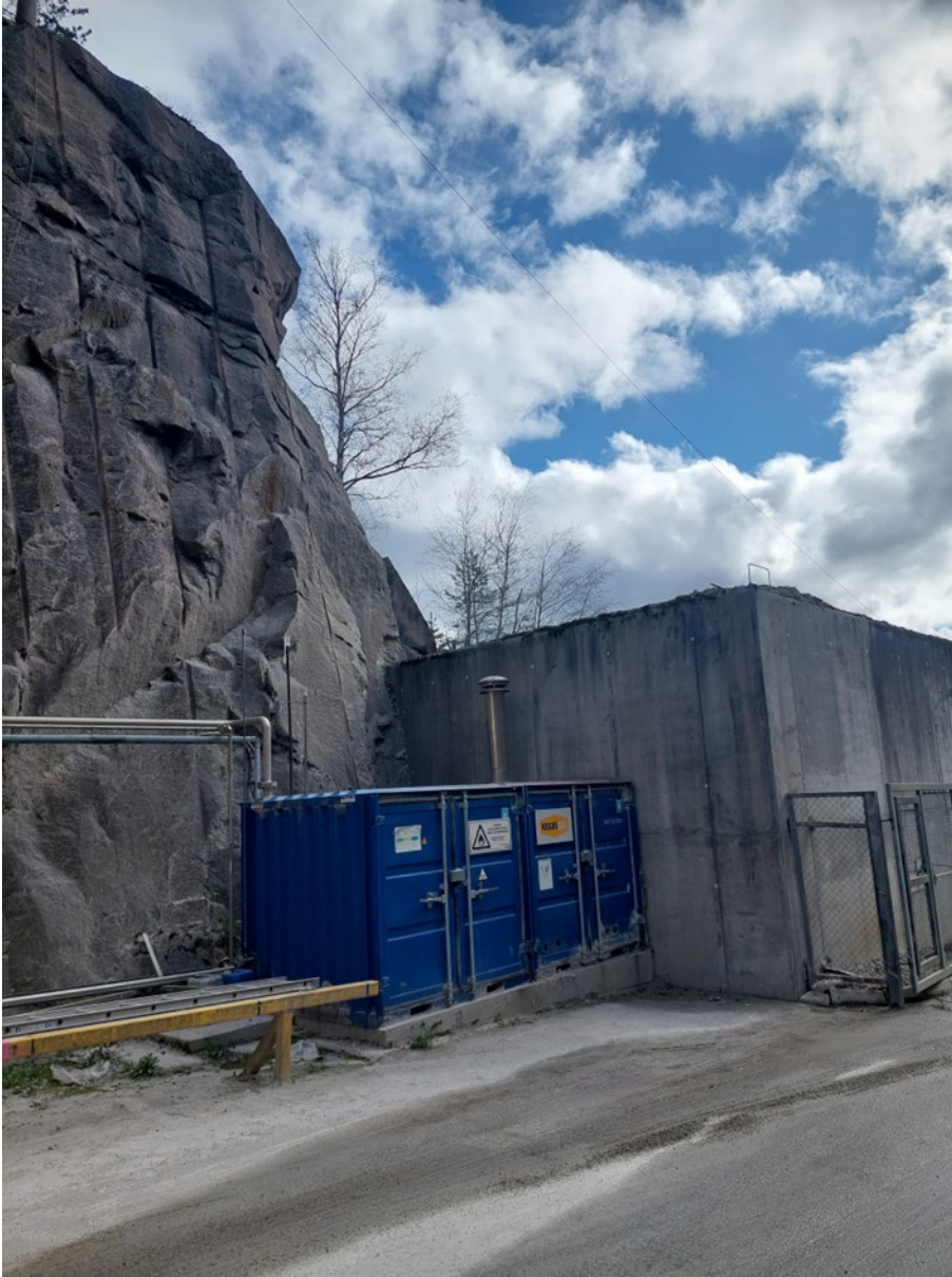
Figur 11: LPG-forbrenningsanlegg plassert i den søndre delen av fabrikkområdet, rett ved inngangen.
