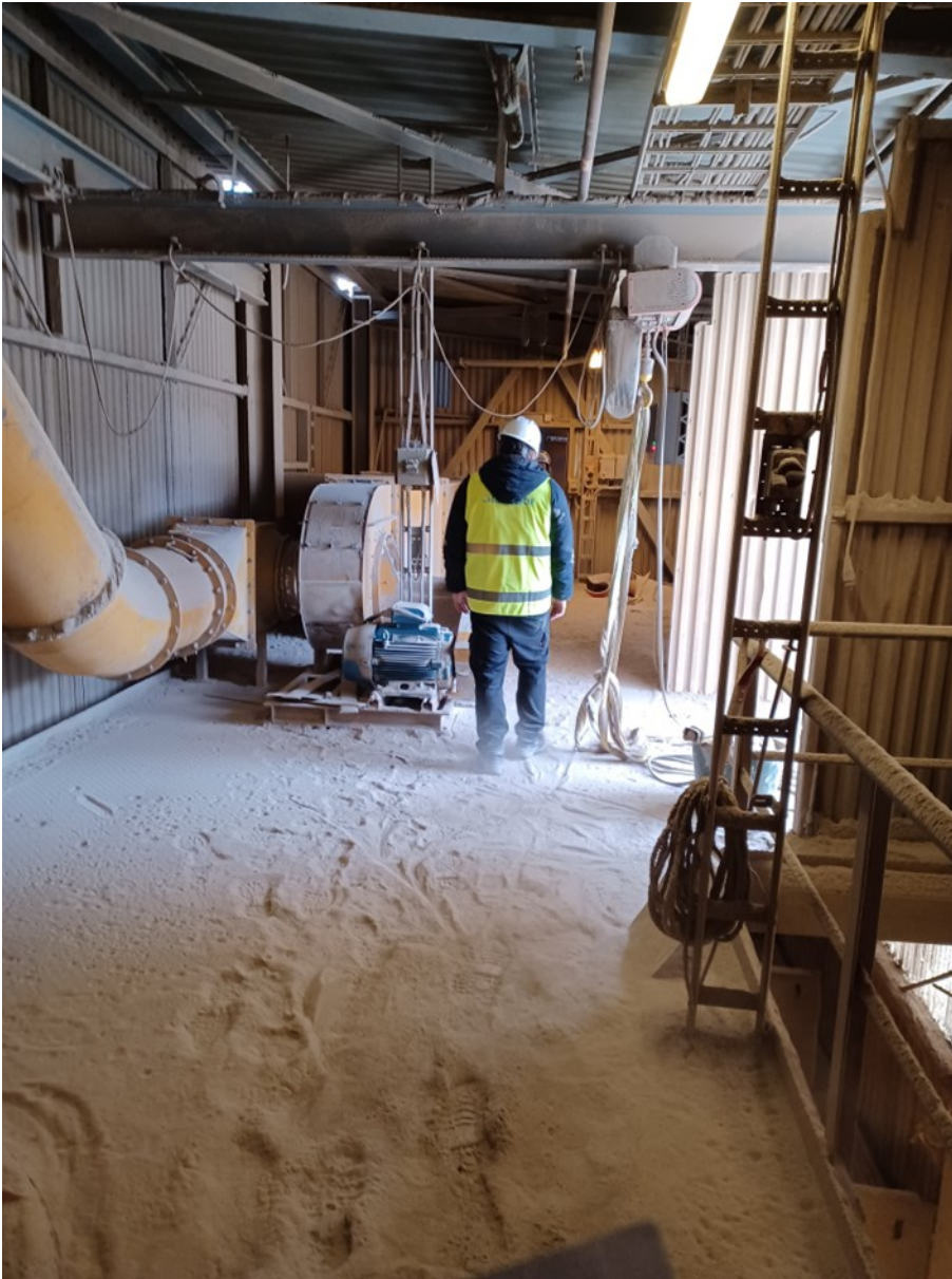
Figur 10: Synlig støv som har bygget seg opp i den eldre delen av anlegget, like over lagringstankene for finmalt glasstøv (se Figur 3). Støvet ligger skjermet for vind og slik sett kan det bygge seg opp et lag av en viss tykkelse. Samtidig er det åpne luker ut i friluft slik at støv kan slippe ut.
