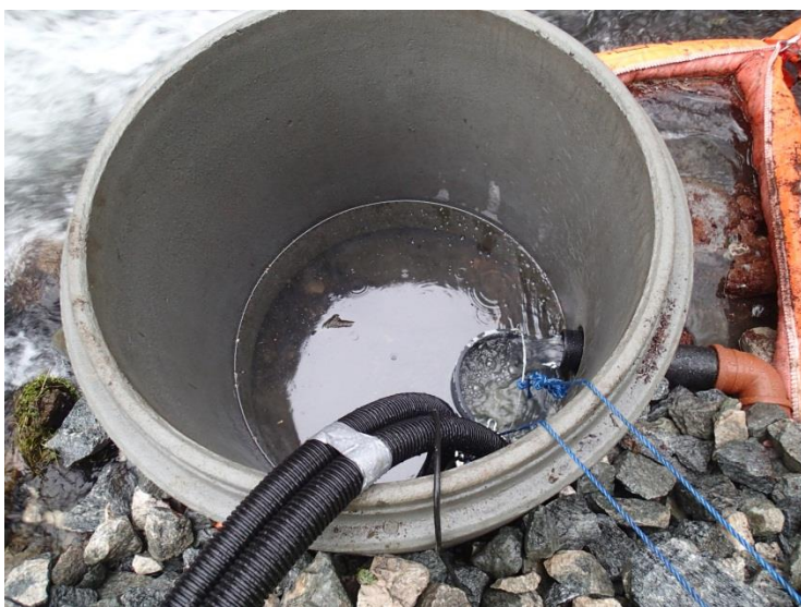
Figur 8. Det ble observert oljefilm på vannet i oljeutskilleren som er etablert i kanten av bekkeleiet til Risa.
