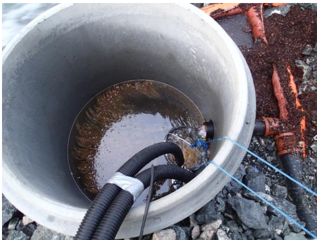
Figur 17. Utseende på vannet i oljeutskilleren den 31. oktober 2013. Oljen var brun og noe emulgert. Lukt av olje i oljeutskilleren.
