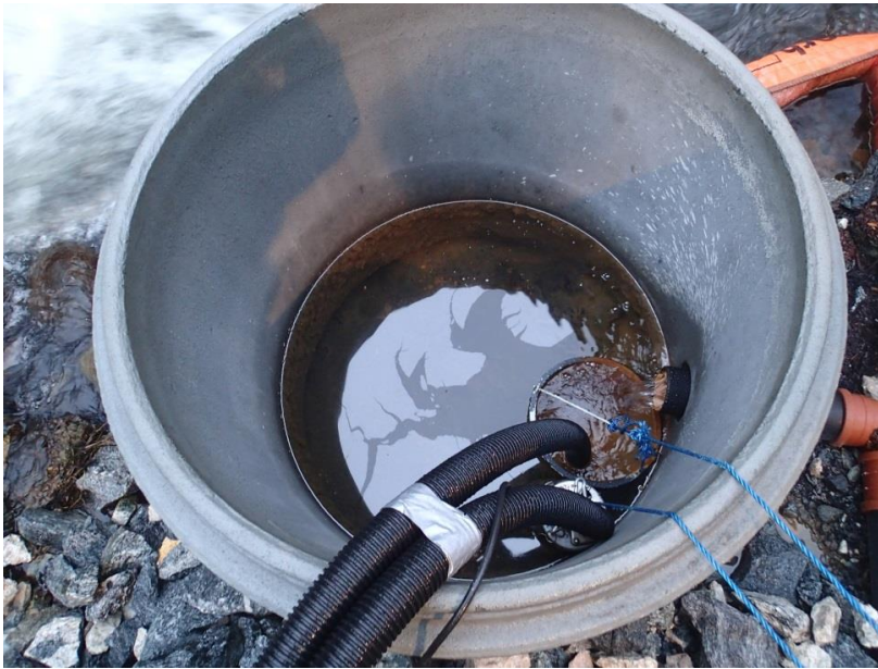
Figur 25. Det ble observert oljefilm på vannet i oljeutskilleren/kummen, på slakteriet Furuset AS, den 9. januar 2014.
