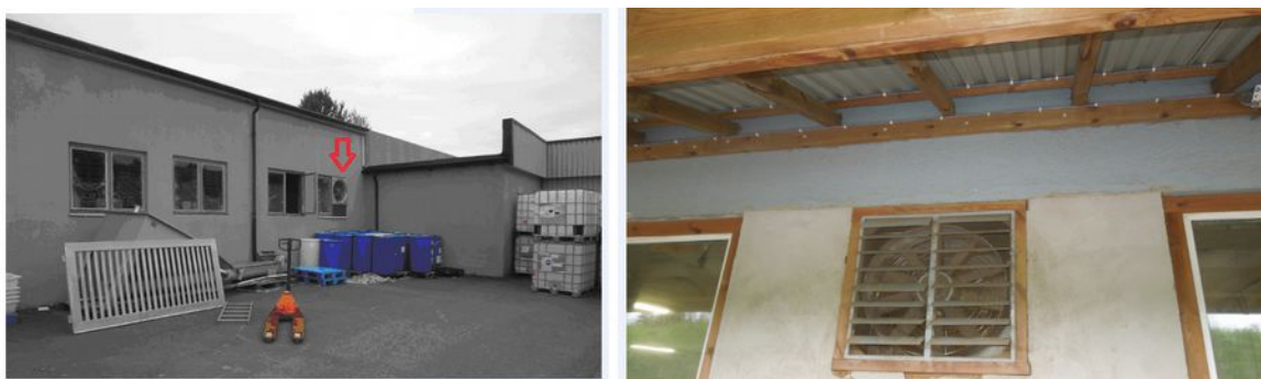
Ventilasjonsåpninger. Den til venstre støyet mest.
