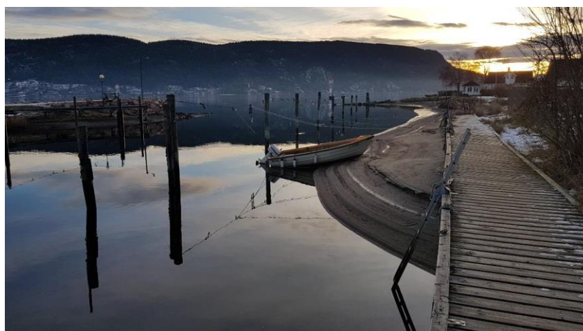
Fig 5 Bilde er tatt fra nord av eksisterende brygge. Her vises opphopning av sand som må fjernes.
