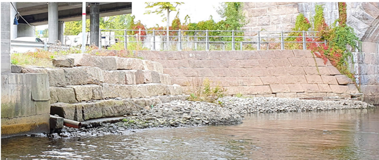
Figur 30 Støttemur langs vestre elvebredd mellom gammel jernbanebru og E18 veibru, utsnitt fra AF Anlegg's bilde 141425 fra 2020
