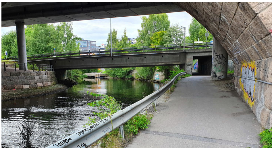
Figur 12 Pilarer for ny jernbanebro og gangvei langs elva, utsnitt fra AF Anlegg's bilde 141732 fra 2020
