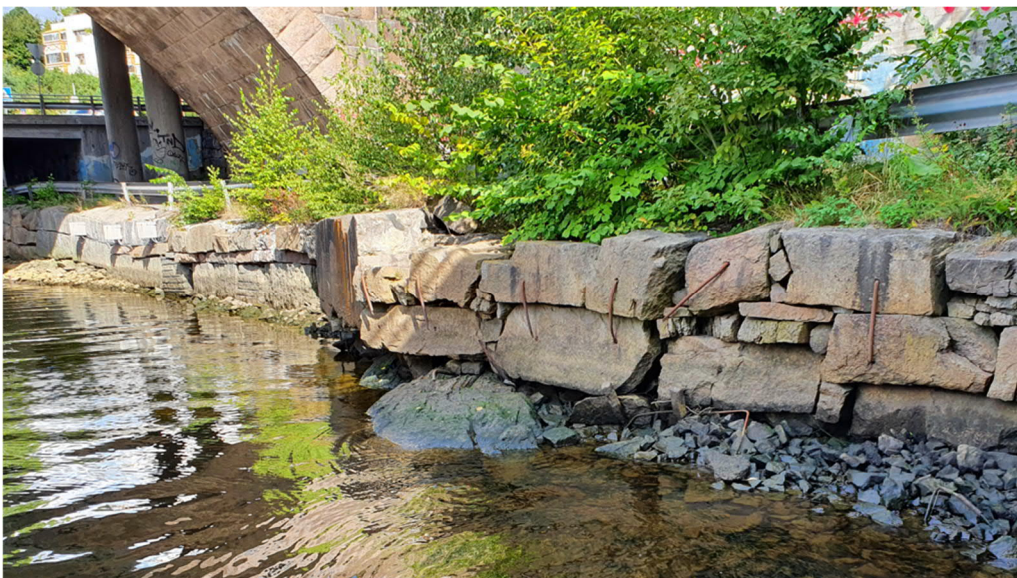
Figur 16 Noe dårlig sikret støttemur nedstrøms østre landkar til jernbanebru, utsnitt fra AF Anlegg's bilde 130302 fra 2020
