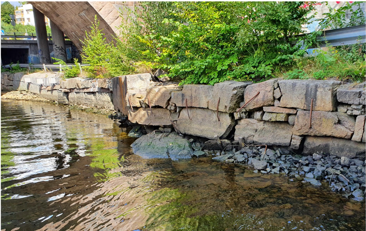
Figur 32 Dårlig sikret støttemur nedstrøms østre landkar til jernbanebru, utsnitt fra AF Anlegg's bilde 130302 fra 2020
