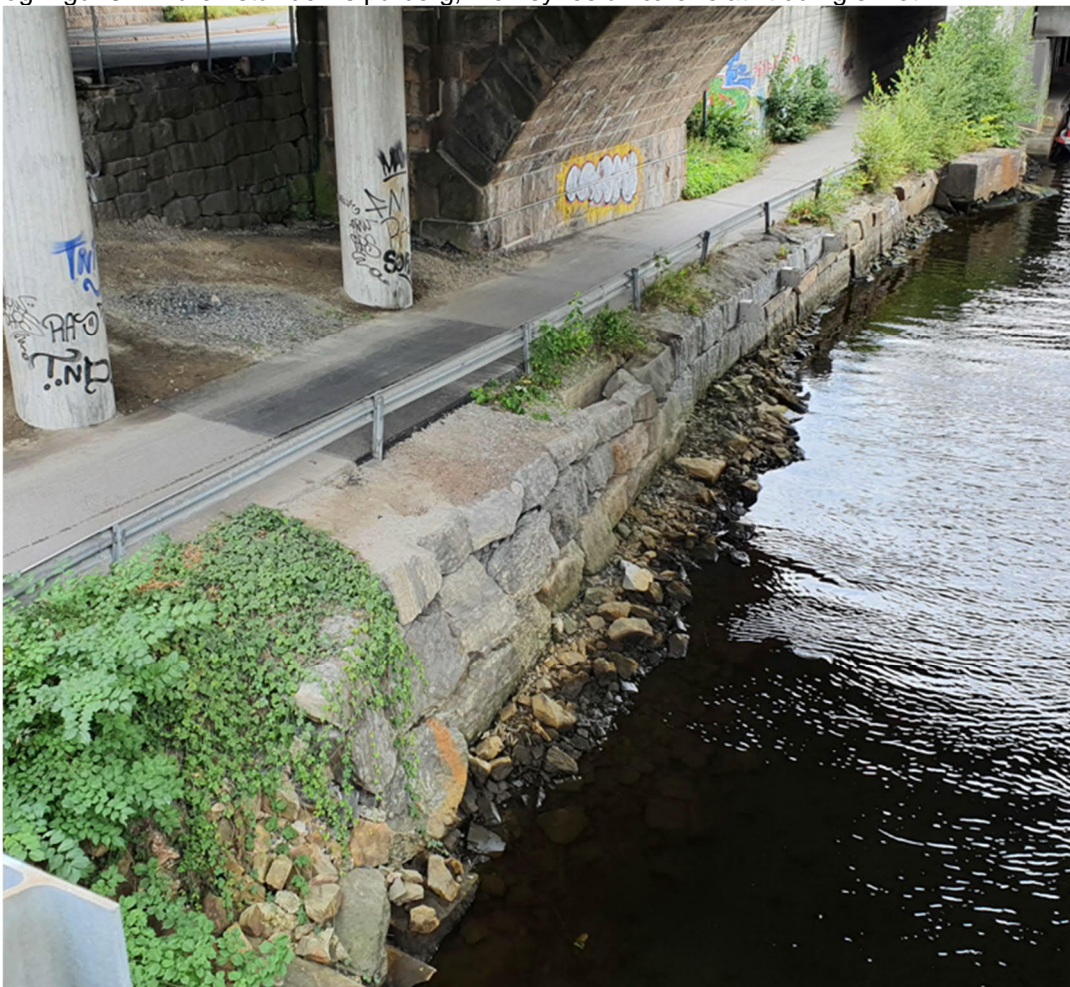
Figur 31 Støttemur langs østre elvebredd mellom øverste veibru og E18 veibru, utsnitt fra AF Anlegg's bilde 142412 fra 2020
