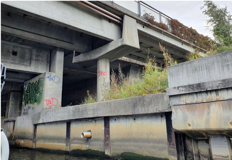
Figur 21 Østre landkar til E18 veibru og sykkelveibru, utsnitt fra AF Anlegg's bilde 141301 fra 2020
