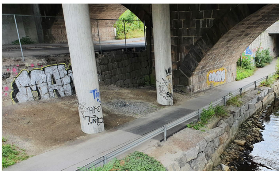
Figur 13 Østre landkar til ny og gammel jernbanebro, utsnitt fra AF Anlegg's bilde 142412 fra 2020
