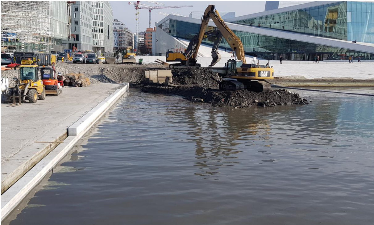
Eksempel på avrenning av oppgravde våte masser innenfor siltgardinen
