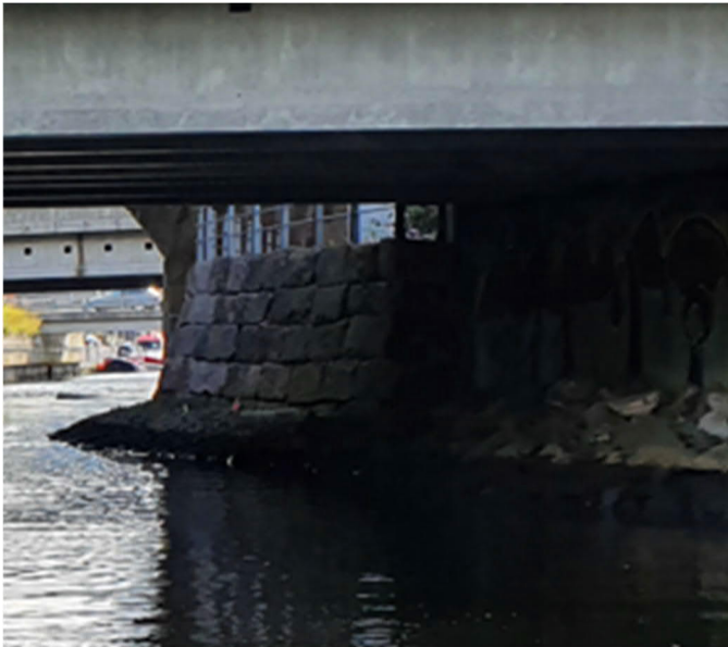
Figur 28 Støttemur langs vestre elvebredd mellom øverste veibru og jernbanebruene, utsnitt fra AF Anlegg's bilde 131202 fra 2020
