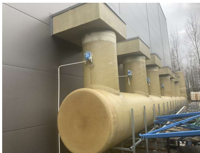
Bildet viser ventilasjonsanlegget for kjemiavdelingen fra utsiden.
